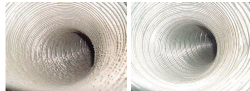
Fig. 2 e 3 - condutas de ar condicionado antes e depois da limpeza
